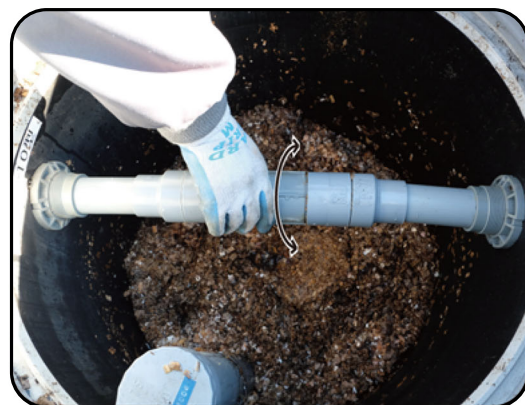
回転ゲート調整 全開状態
